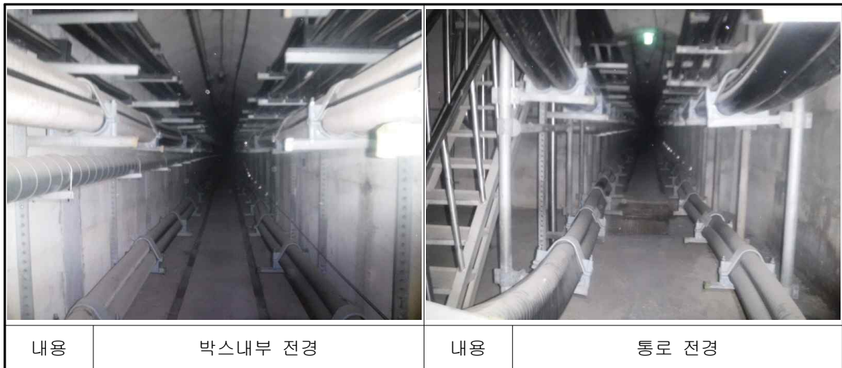
[사진 1.1] 구리인출 전력구 현황
